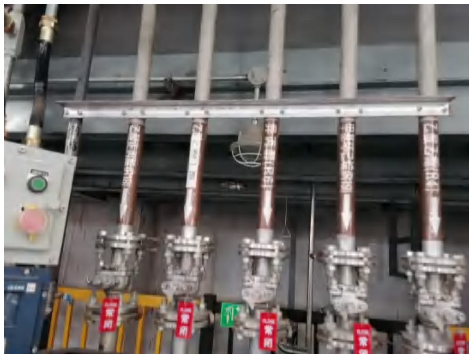
液体物料输送管道
