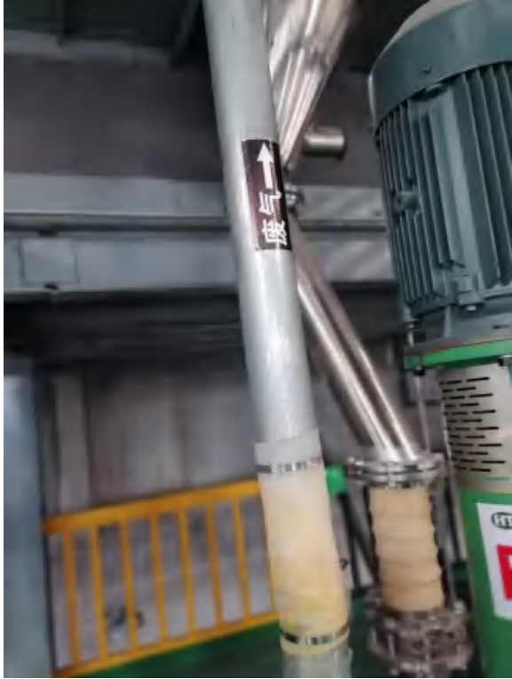
粉料进料管、废气管
